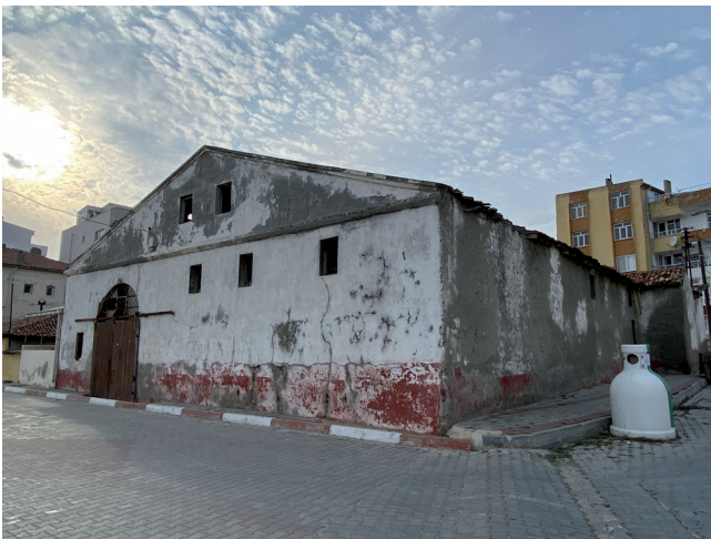
Resim 27. Ş12 şaraphanesinin cephesinde görülen rutubetlenme (Beste Güzel, 2019)
